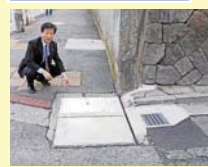
転倒防止のグレーチング
