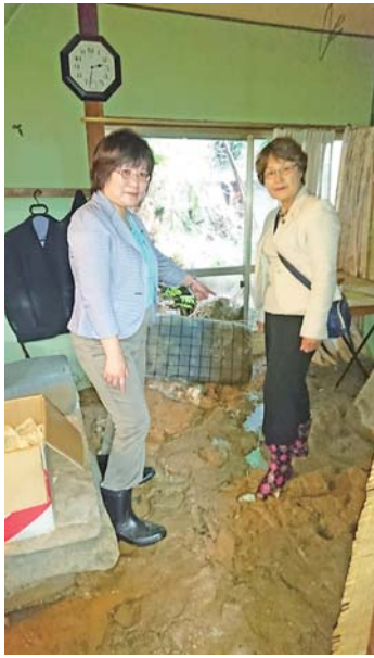
土砂が窓を破り住宅内になだれ込んでいます。左・藤元市議、右・高瀬県議（10月2日、西台良）
