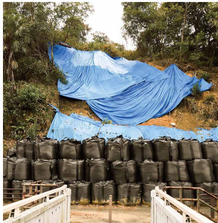
板櫃町のがけ崩れ現場
