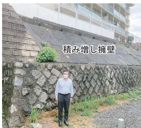
小倉北区井堀2丁目市住「仲通り団地」南側の擁壁
