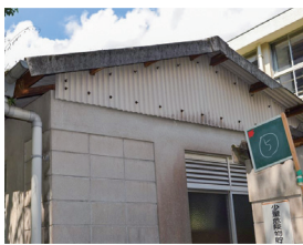
↑屋根の素材にアスベスト使用疑い
