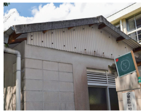
↑屋根の素材にアスベスト使用疑い
