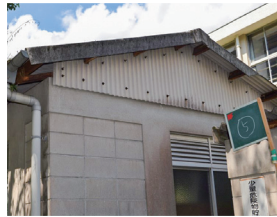
↑屋根の素材にアスベスト使用疑い
