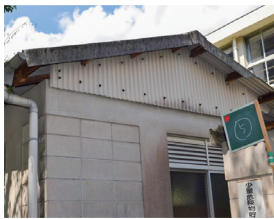
↑屋根の素材にアスベスト使用疑い
