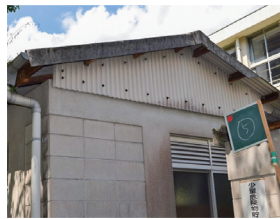
↑屋根の素材にアスベスト使用疑い
